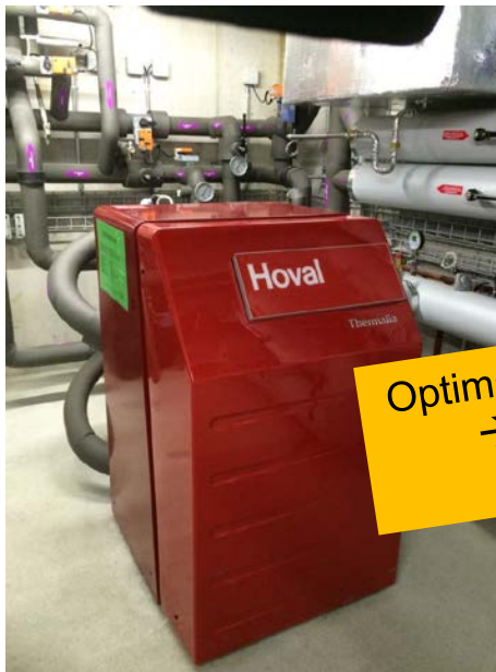
Wärmetauscher im Batterieraum
